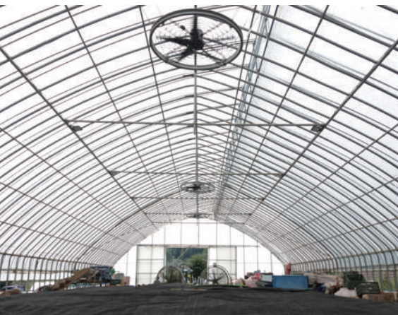
감자 창고 천장에 설치한 선풍기
